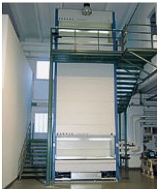
Slika 17. Instalirani VLM s dva otvora [2]
