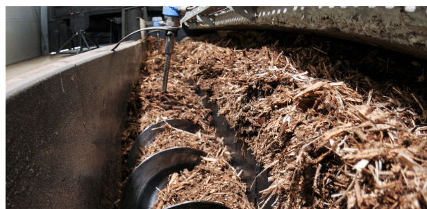
d) prijenos biomase pužnim vijcima
