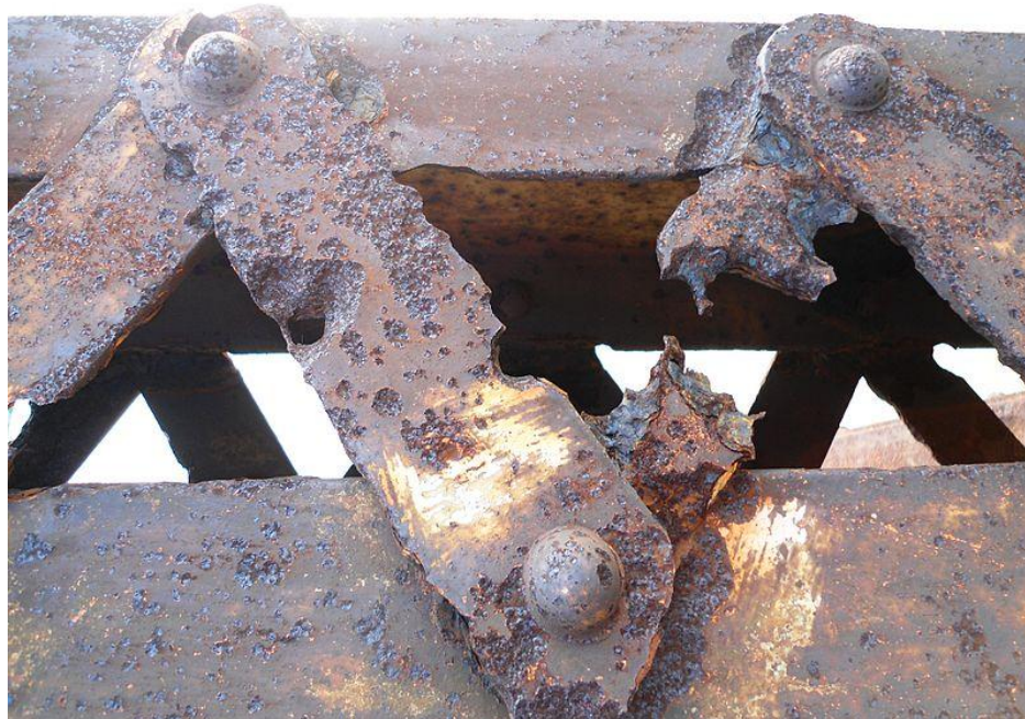
Slika 22. Konstrukcija mosta zahvaćena rupičastom korozijom [29]
