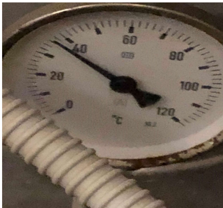
Slika 34. Temperature PTV-a u 2. spremniku (bojleru)
