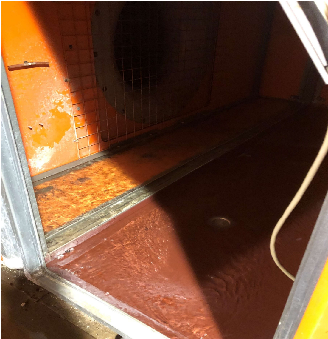
Slika 41. Prikaz nakupljenog kondenzata u klima-komori
