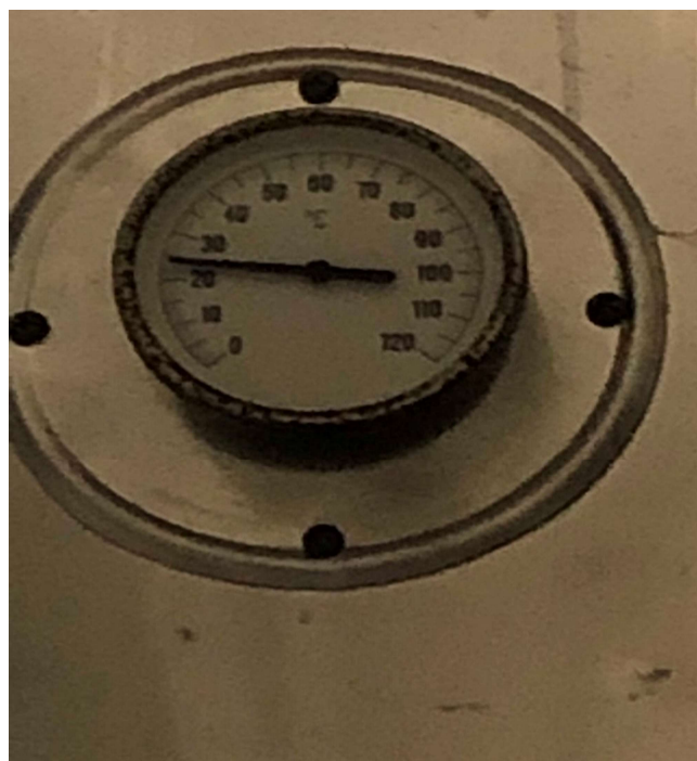
Slika 30. Temperature PTV-a u 1. spremniku (bojleru)
