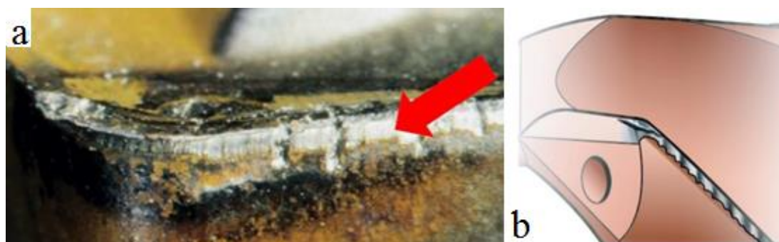
Slika 20. Toplinska napuknuća a) prema [25], b) prema [12]
