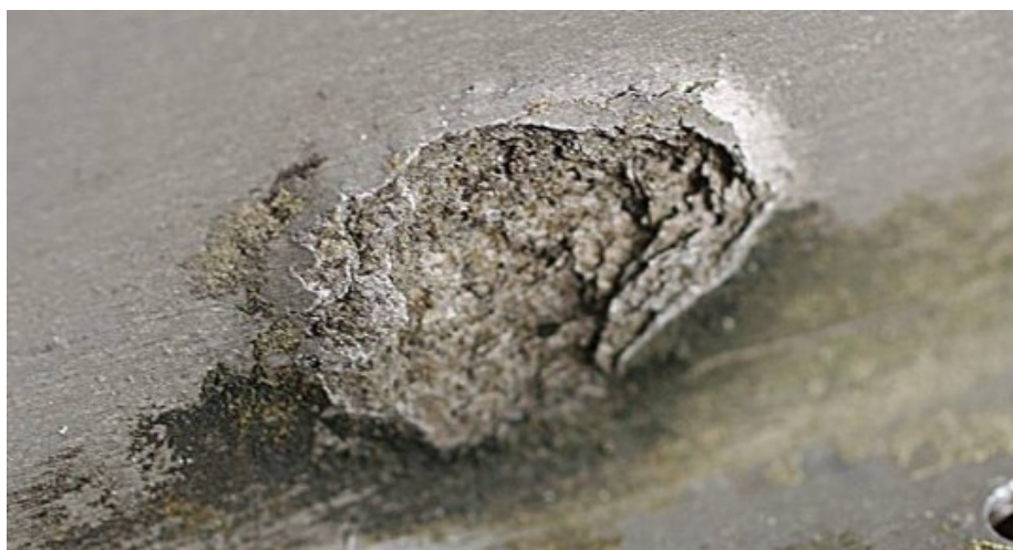
Slika 21: Raspljavanje aluminijske legure uslijed interkristalne korozije [37]
