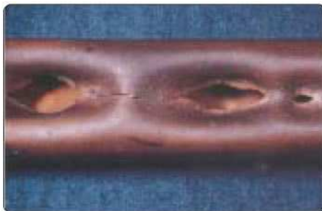
slika 1.1 – cijev oštećena hidrauličkim udarom
