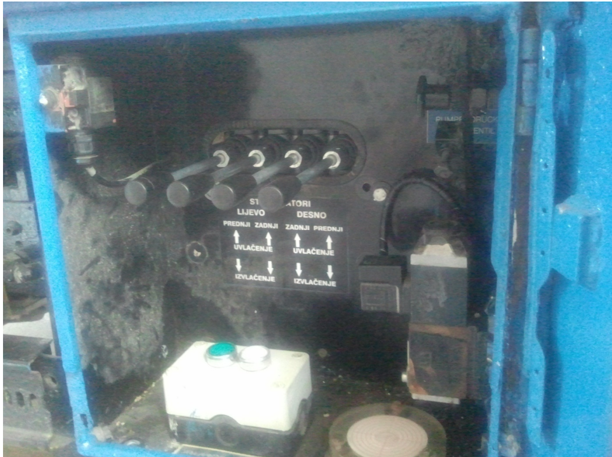
Slika 6.3 Ormarić za ručnu i automatsku nivelaciju
