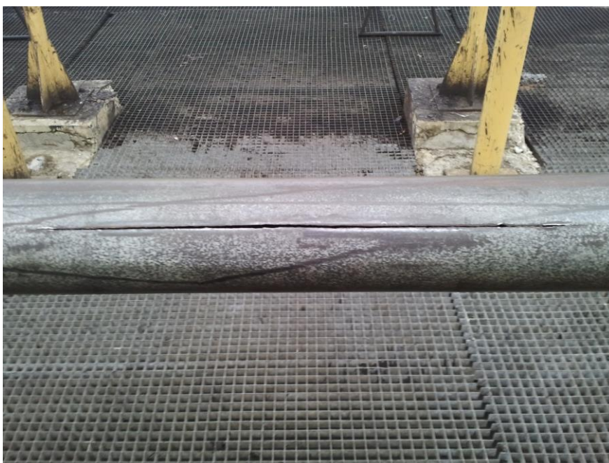
Slika 5. Primjer oštećenja na crpnoj cijevi uzrokovanog trenjem šipke, vanjsko puknuće (naftno polje Žutica)
