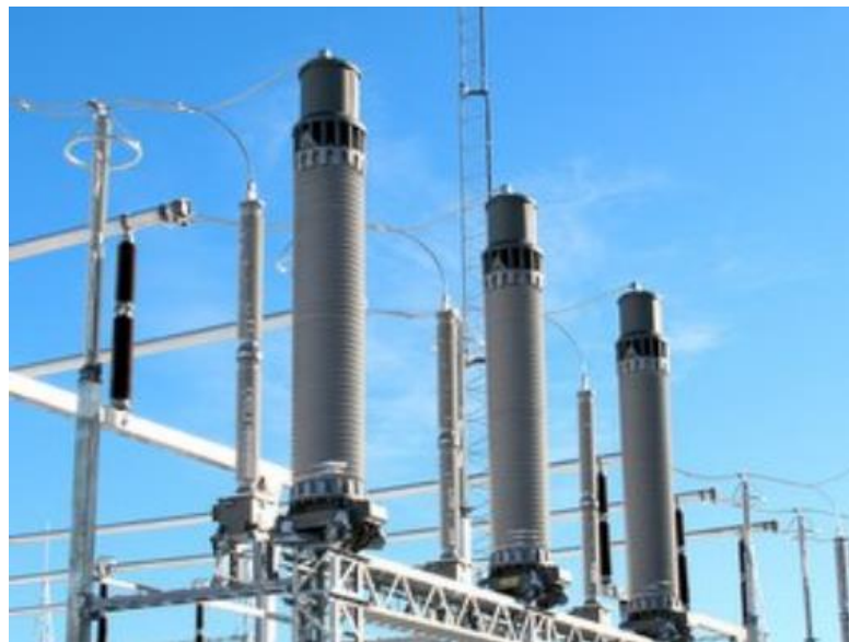
Slika 5. Naponski mjerni transformator velike snage VPT[1]
