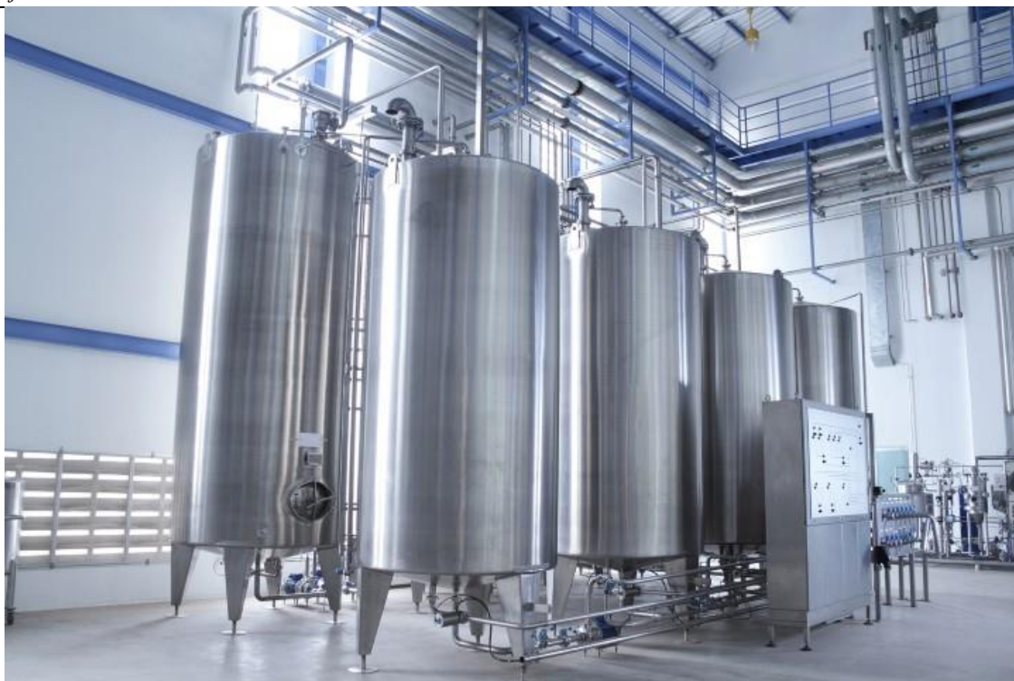
Slika 7. Postrojenje načinjeno od dupleks čelika [9]
