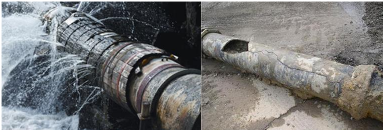
Slika 1 – Puknuće cijevi uzrokovano hidrauličkim udarom [1]
