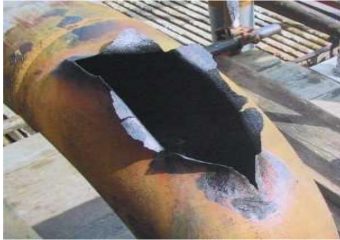
Slika 11. Erozijsko korozijsko oštećenje cijevi za transport nafte [10]
