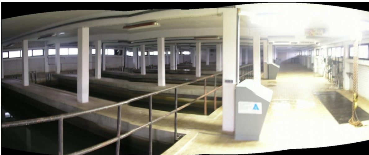
Slika 3.2 Prikaz hale u kojoj su smješteni filtracijski bazeni
