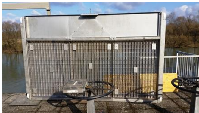
Slika 2.2 Rešetka za uklanjanje grubljih mehaničkih nečistoća skinuta radi remonta [1]
