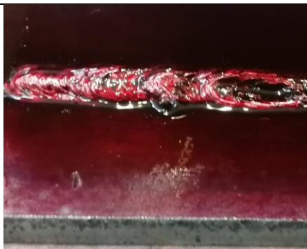
Slika 51. Penetrant na zavaru 1
