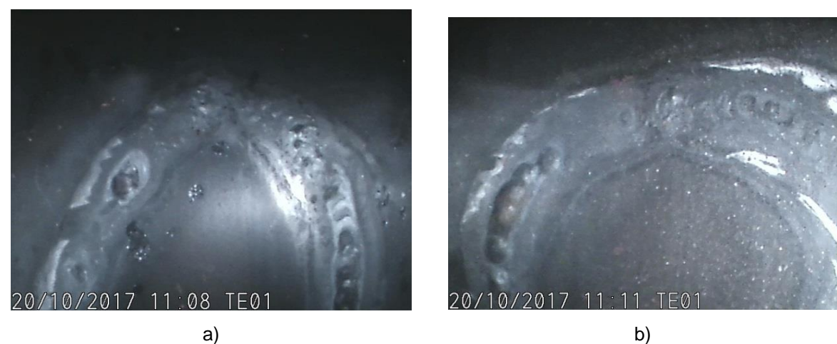
Slika 48. Segment šasije PODNICA: stanje unutrašnje površine cijevu, detalji zavora
