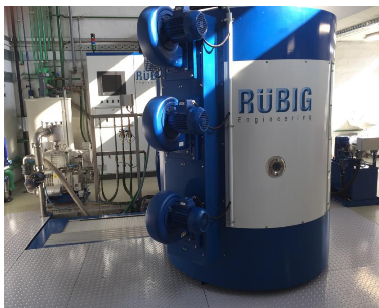
Slika 15 Industrijska peć RUBIG GmbH Type PC 70/90 instalirana na Fakultetu strojarstva i brodogradnje]
