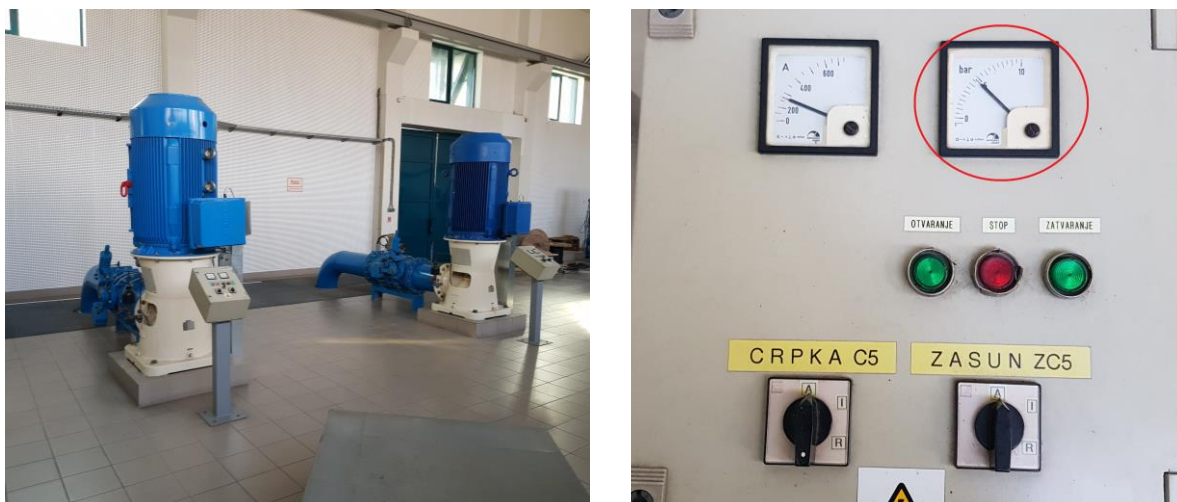
Slika 5.11 Sustav za crpljenje vode u vodoopskrbnu mrežu
