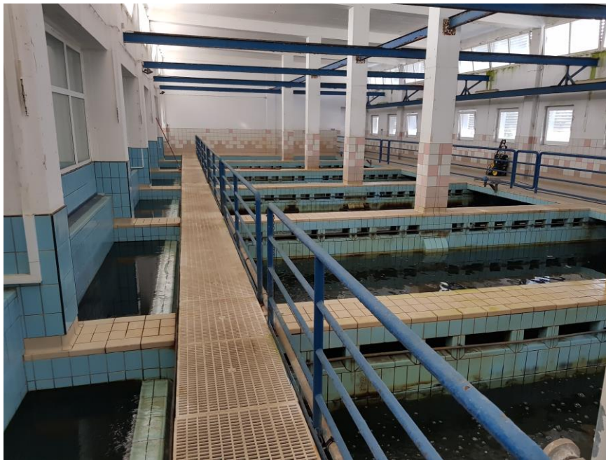
Slika 5.10 Sustav za filtraciju vode
