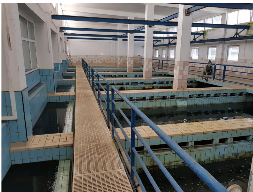
Slika 5.10 Sustav za filtraciju vode
