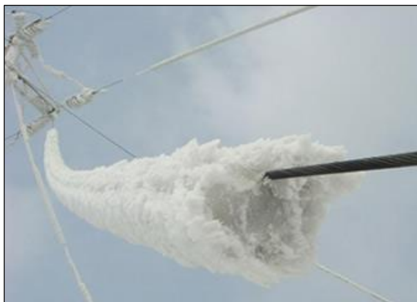
Slika 2.8. Dodatni teret na vodičima dalekovoda u eksploataciji [12]
