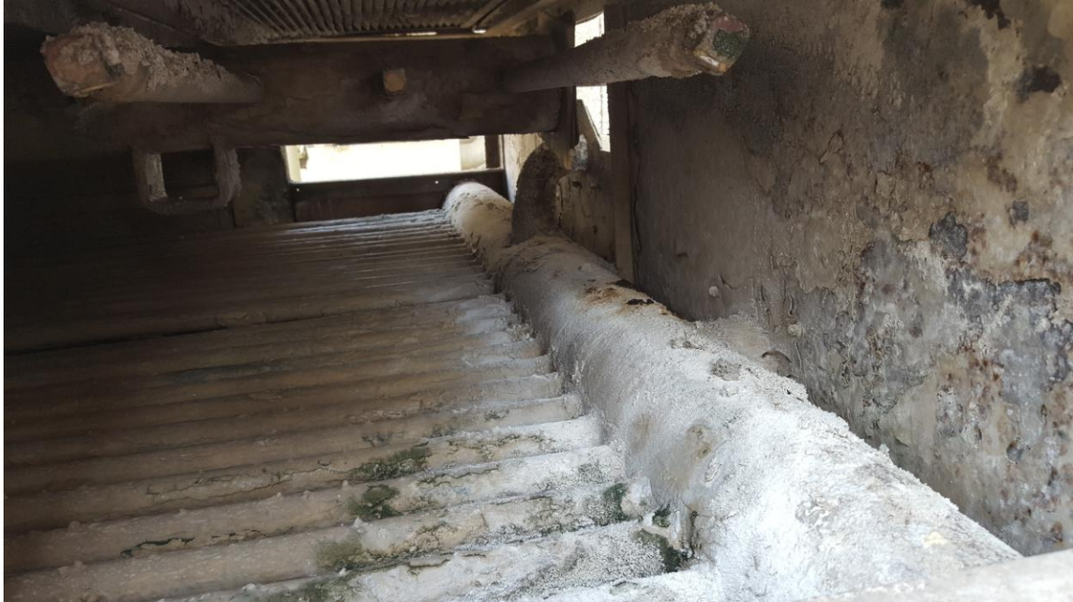
Slika 6. Kamenac u evaporativnom kondenzatoru
