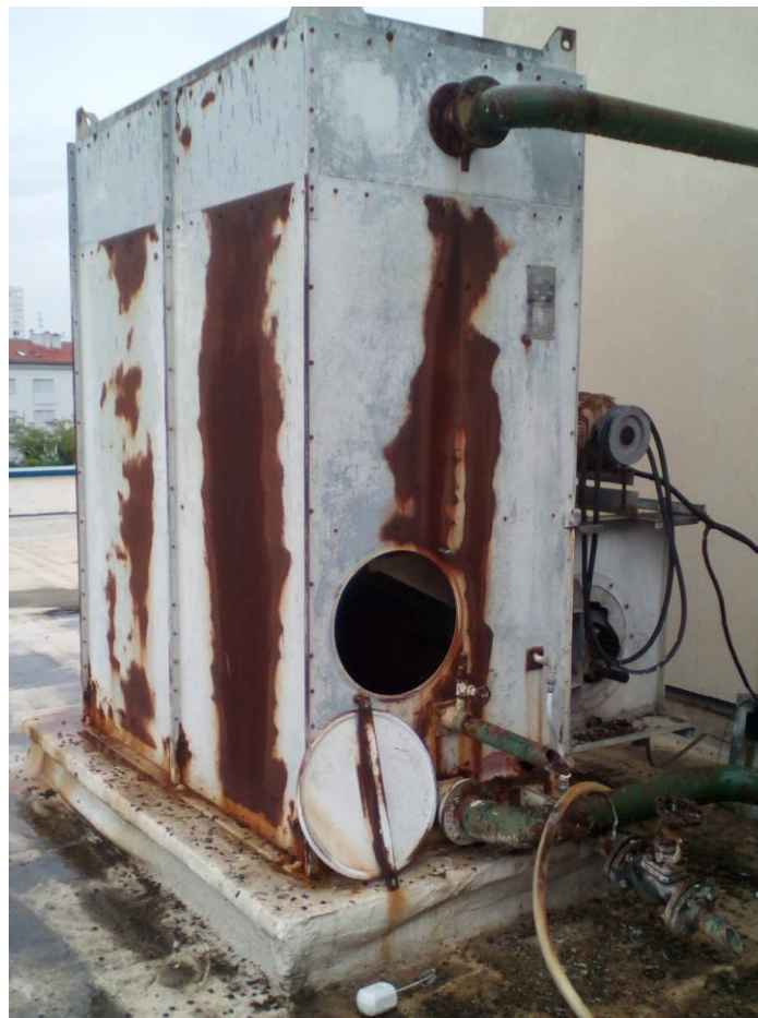
Slika 5. Neodržavani evaporativni kondenzator
