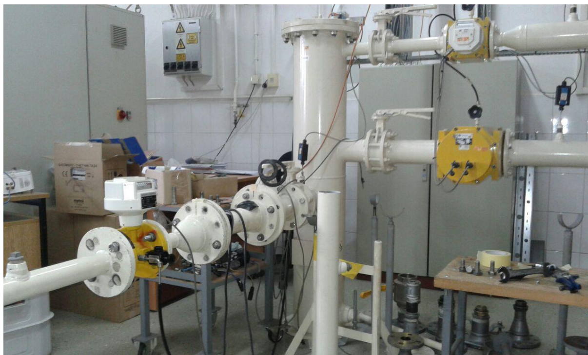
Slika 19 Sustav za ispitivanje velikih protoka Gradske plinare Zagreb
