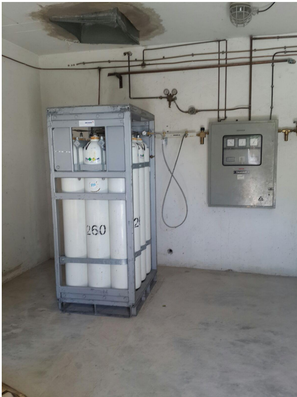
Slika 24. Razvodni sustav za dušični oksidul
