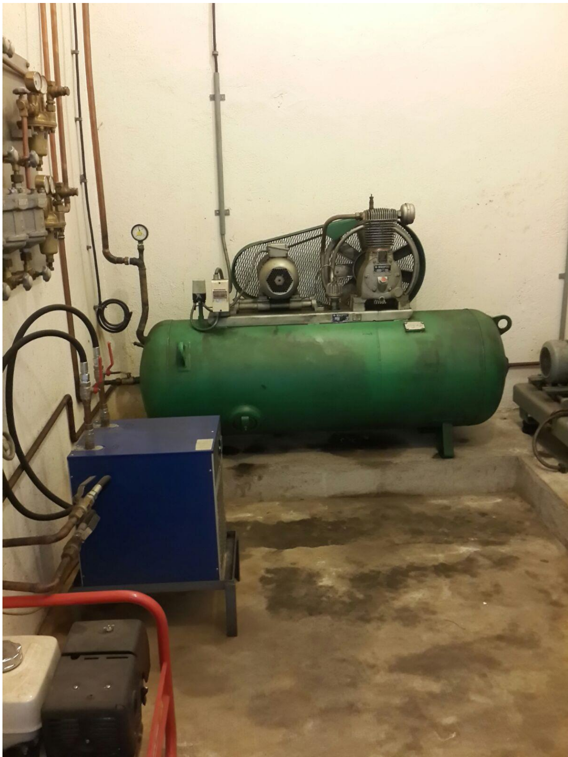
Slika 21. Kompresor za visokokomprimirani medicinski zrak (10 bar)
