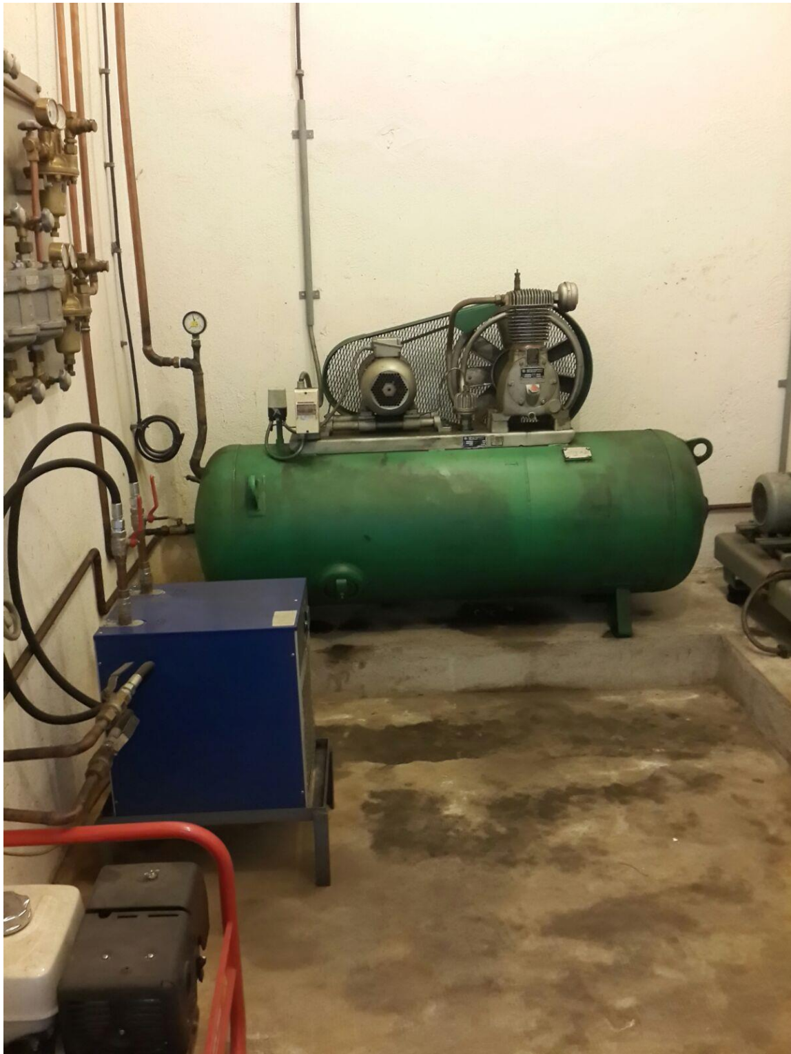
Slika 21. Kompresor za visokokomprimirani medicinski zrak (10 bar)
