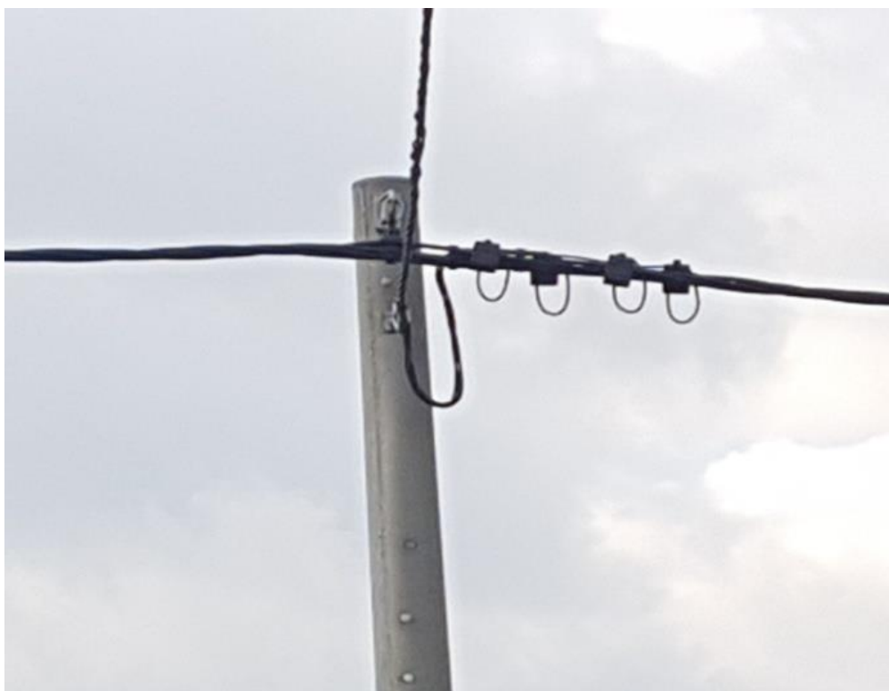
Slika 1. Izolirana odcjepna stezaljka na kablenskom snopu
