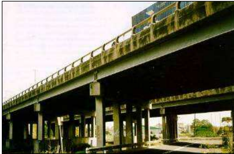
Slika 29. Most zaštićen vodorazrijedivim premazom [12]
