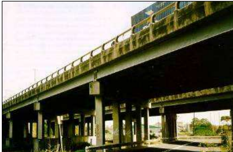
Slika 29. Most zaštićen vodorazrijedivim premazom [12]
