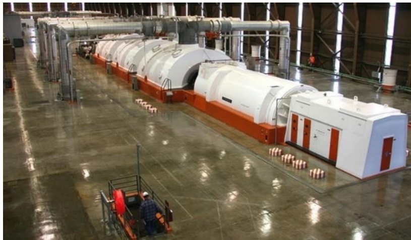
Slika 7. Sklop turbina - generator
