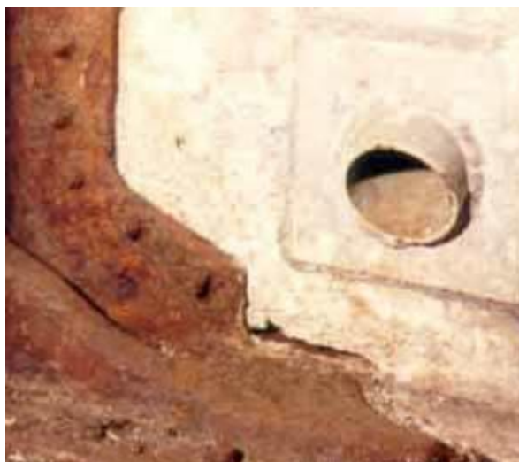
Slika 7. Kontaktne korozija aluminija u dodiru s čelikom [9]
