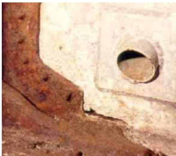
Slika 7. Kontaktna korozija aluminija u dodiru s čelikom [9]
