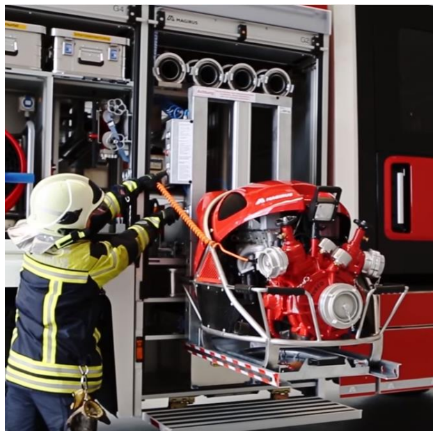
Slika 3. Primjer smještaja pumpe u vozilu
