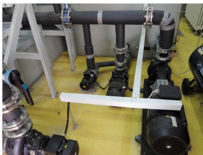
Slika 20. Pumpe za dobavu vode
