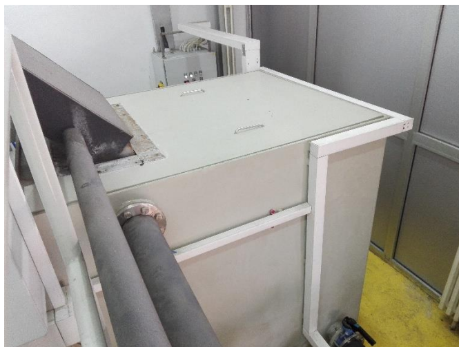
Slika 23. Glavni spremnik sa vodom
