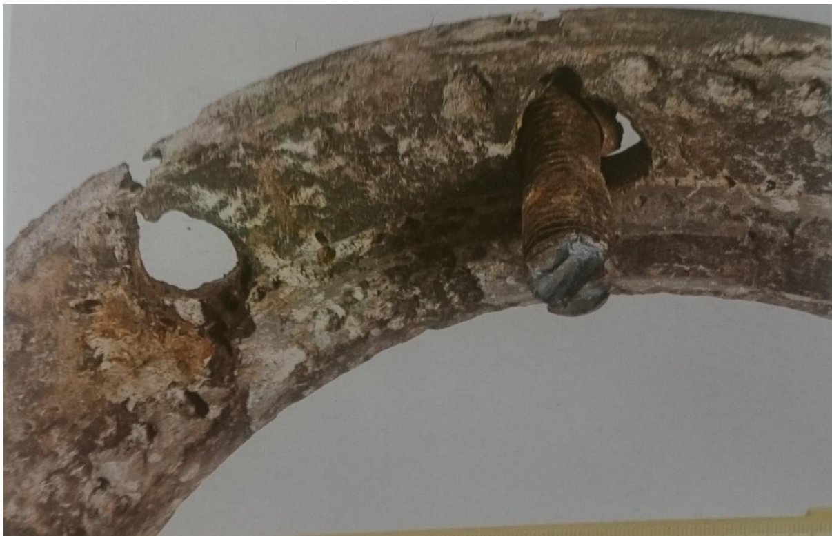
Slika 4. Galvanska korozija aluminijskog predmeta [5]
