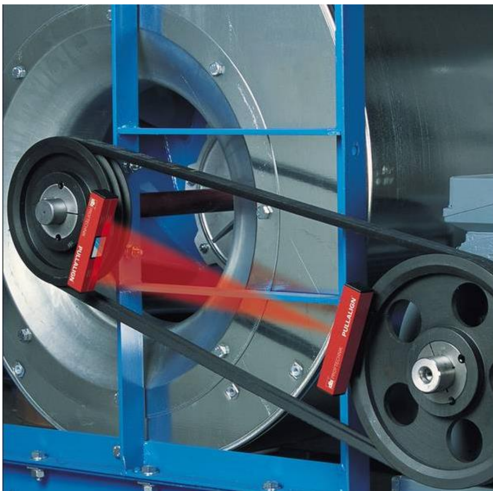
Slika 28. Montiranje sustava PullAlign za lasersko centriranje na remenice [10]
