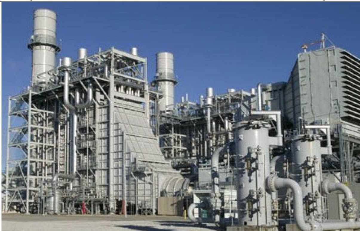
Slika 29. Kotao na otpadnu toplinu (HRSG) [9]
