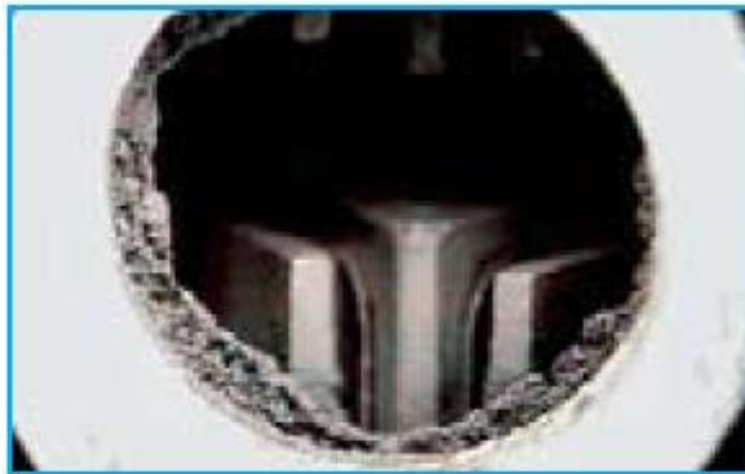
Slika 18. Naslage u nepovratnom ventilu [6]
