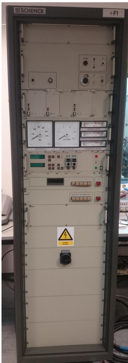
Slika 8.7 Upravljački ormar hidrauličke kočnice
