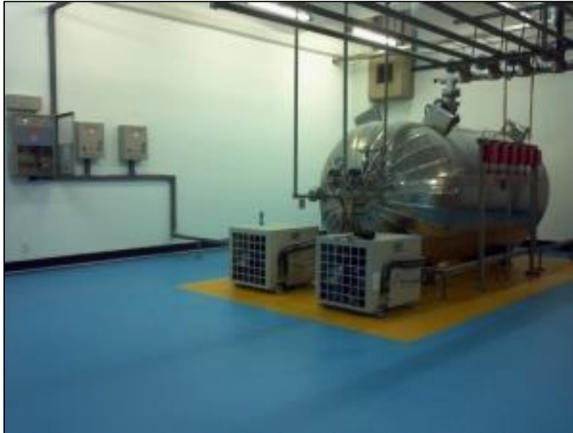
Slika 10. Spremnici medija za gašenje niskotlačnog CO 2 sustava [12]
