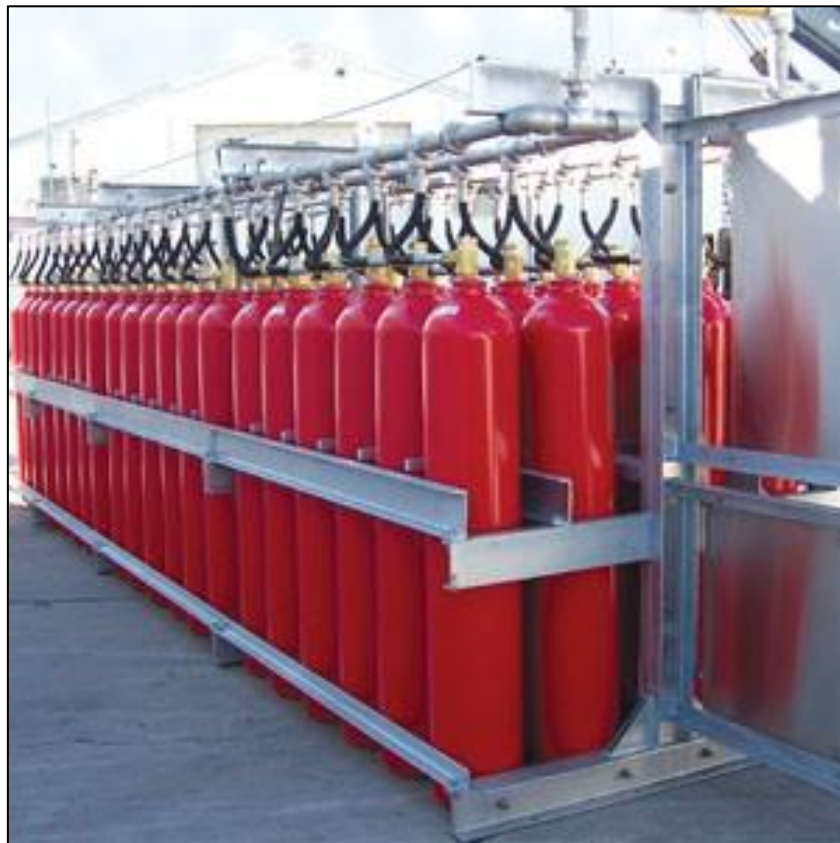
Slika 9. Spremnici medija za gašenje visokotlačnog CO 2 sustava [11]
