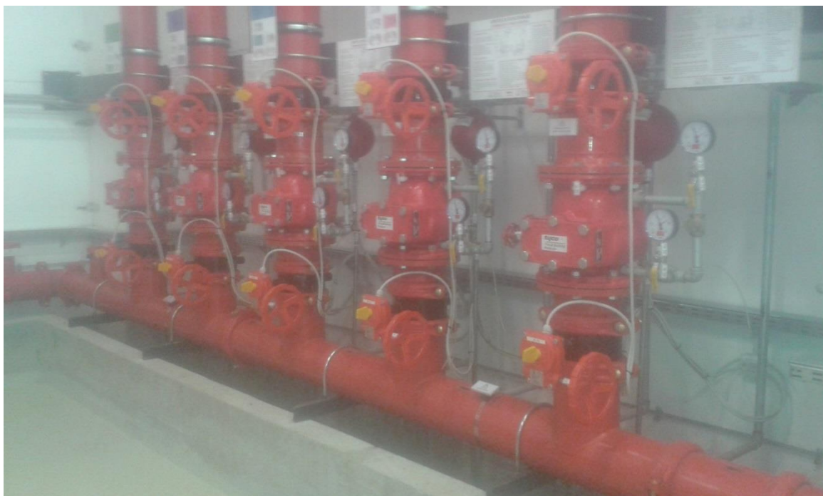
Slika 36. Ventilске stanice mokrog sprinkler sustava
