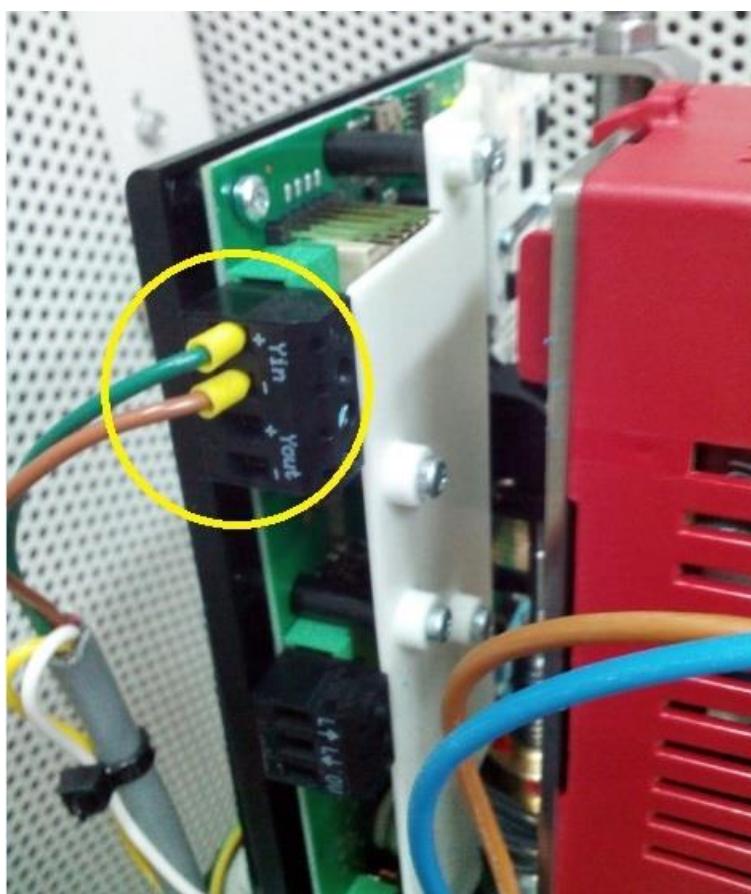
Slika 3.11. Spajanje signalnog kabla na aktuator.
