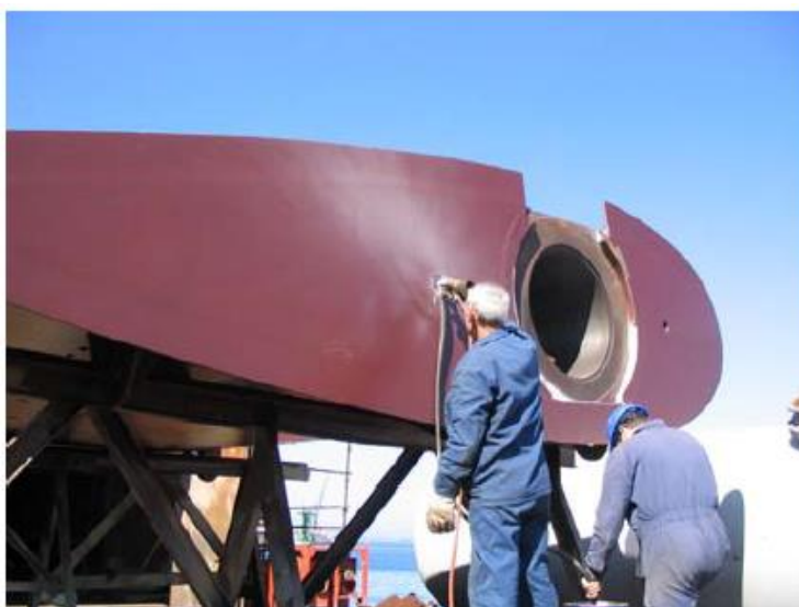
Slika 16. Primjena inhibitora korozije za zaštitu unutrašnjosti lista kormila [14]
