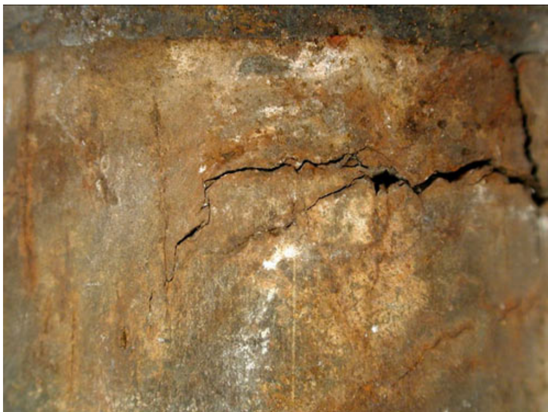
Slika 13. Austenitni nehrđajući čelik (316Ti) zahvaćen napetosnom korozijom [19]
