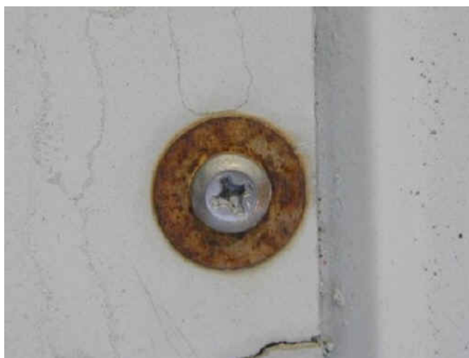
Slika 9. Galvanska korozija nastala zbog razlike potencijala između vijka i podloške [14]
