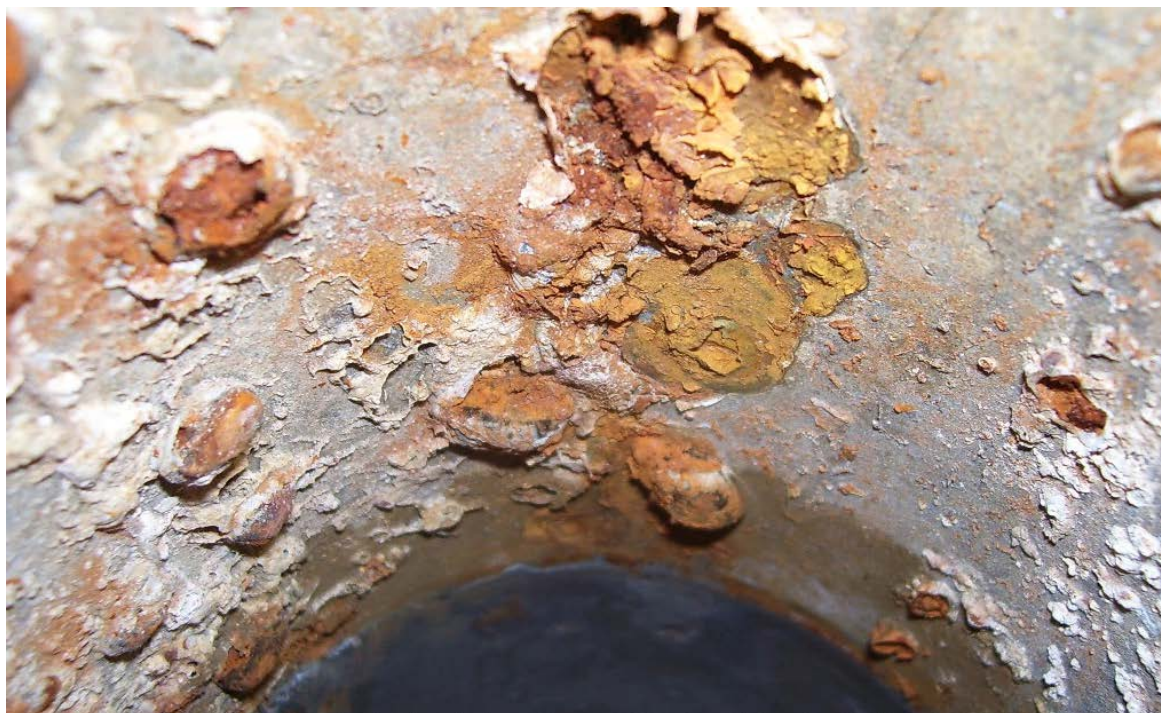
Slika 15. Mikrobiološki poticana korozija na unutarnjoj stijenci cijevi od nehrđajućeg čelika [22]
