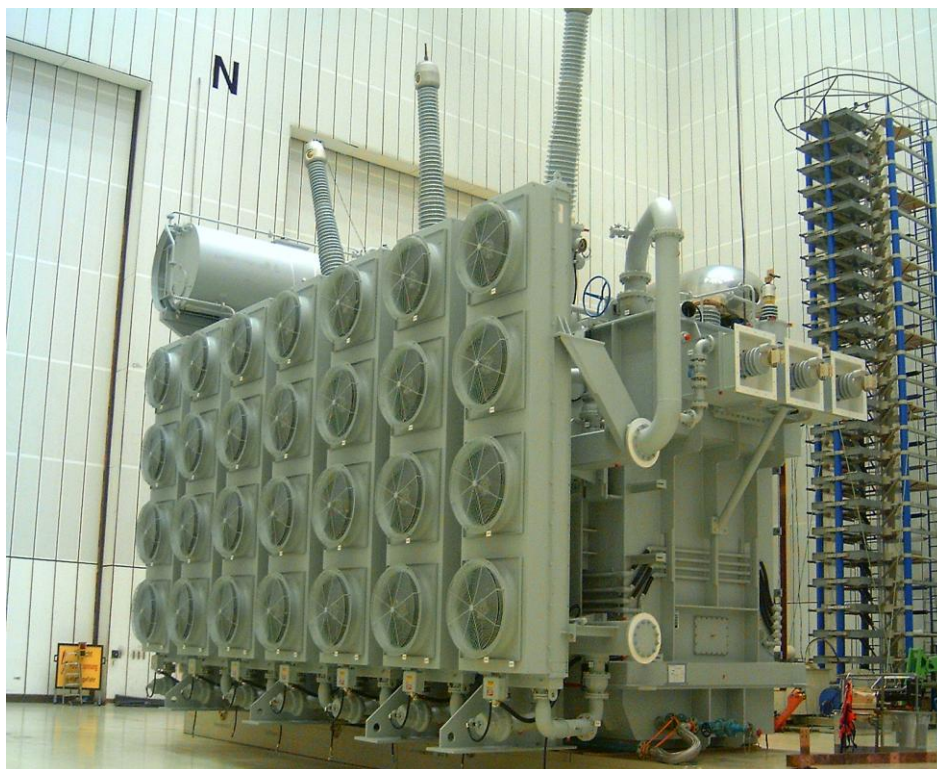
Slika 1.1. - Transformator s hladnjakom
