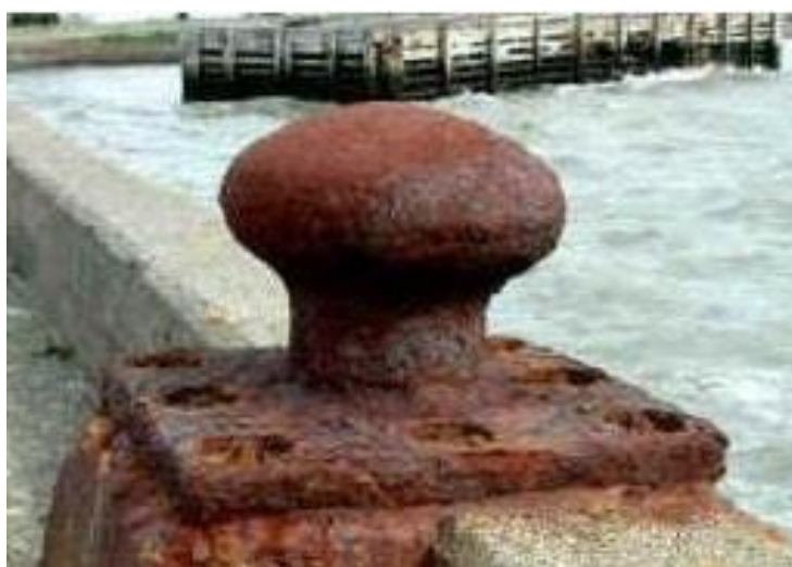
Slika 2. Primjer opće korozije [8]
