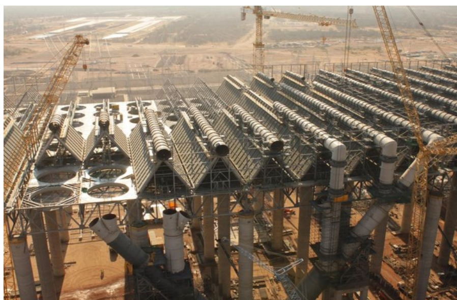
Slika 49. Prikaz izmjenjivačkih površina kondenzatora
