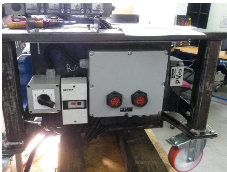
Slika 34. Elektroormar sa pripadajućim sklopkama
