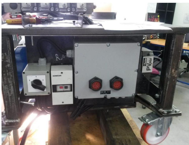
Slika 34. Elektroormar sa pripadajućim sklopkama
