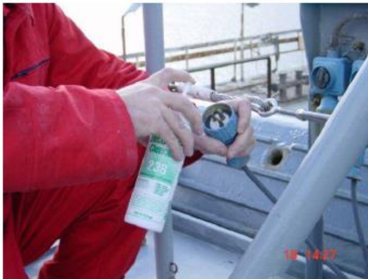
Slika 13. Primjena inhibitora za zaštitu električnih kontakata [12]
