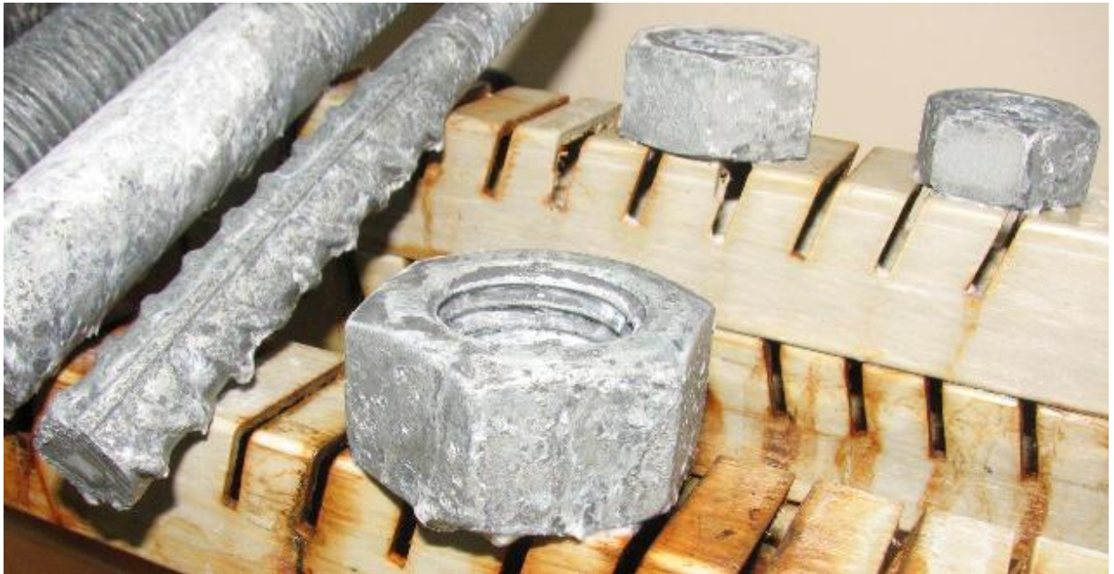
Slika 6.20. Bijela korozija cinka na vruće cinčanim uzorcima [22]
