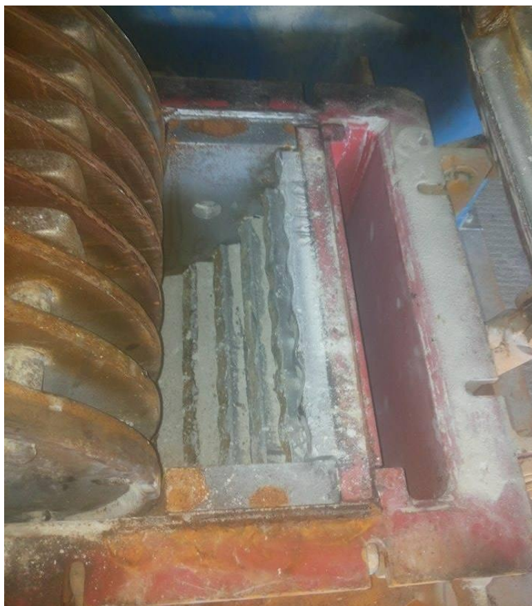
Slika 46. Udarne obloge ispod rotora u kućištu mlina
