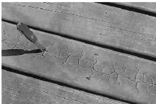
Slika 3. Pukotine na drvu nastale pod dugotrajnim utjecajem atmosferskih uvjeta [9].
