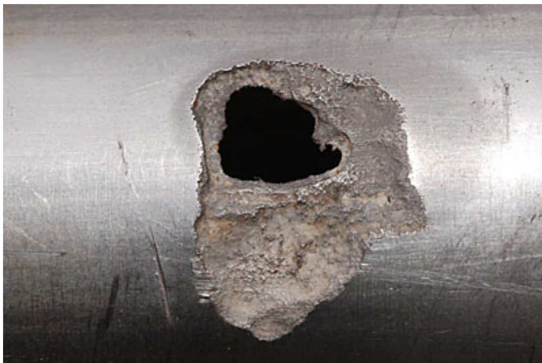
Slika 13. Galvanska korozija uzrokovana lutajućom strujom iz električne žice u blizini cijevi od nehrđajućeg čelika [20]
