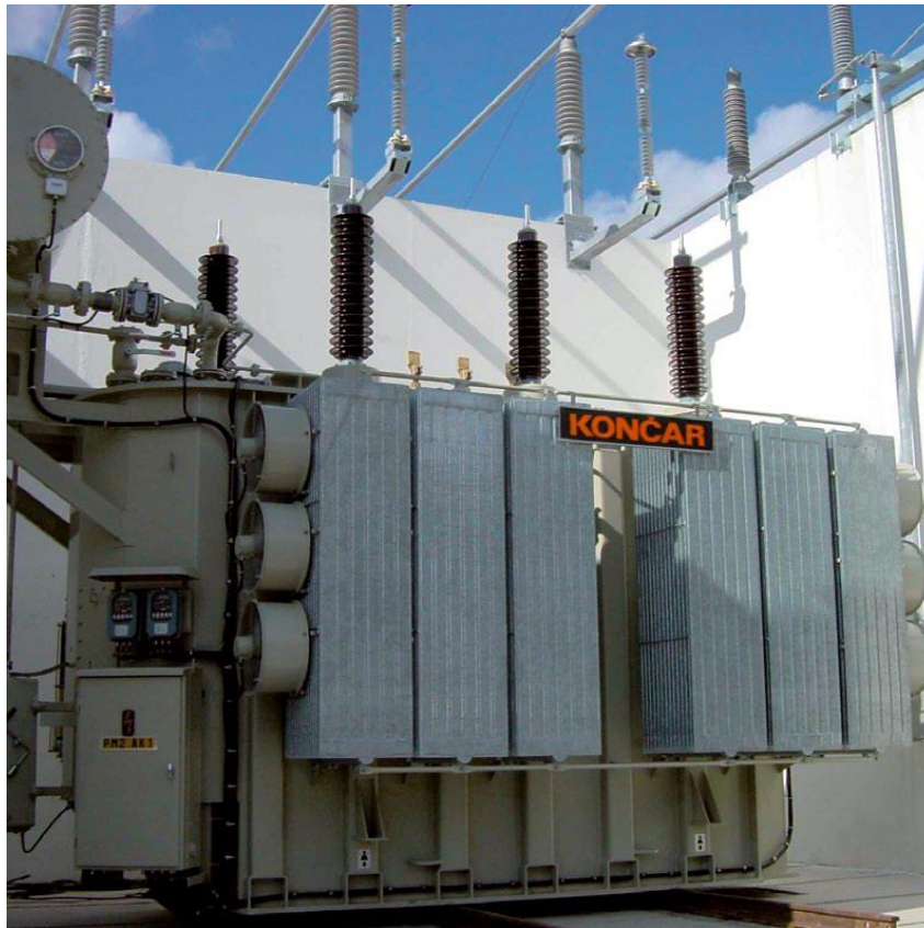
Slika 14. Primjer srednjeg energetskog transformatora. [23]
