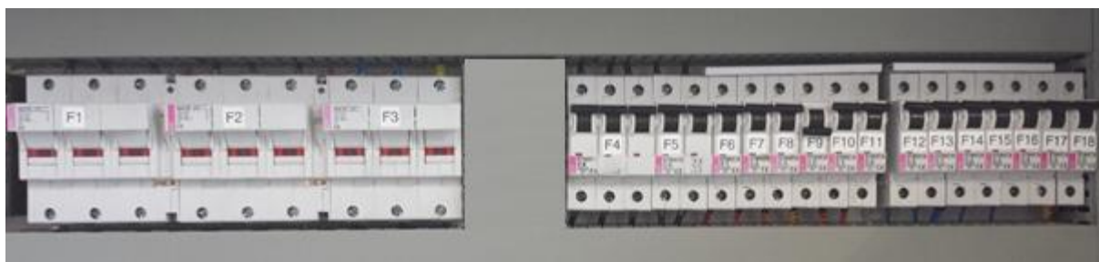
Slika 4.23 Zaštitne sklopke elemenata elektro-ormara
