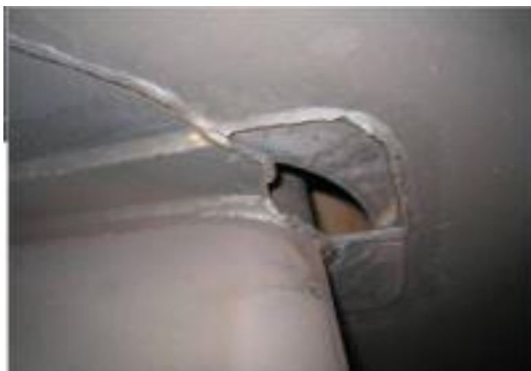
Slika 1.3 Prikaz pukotine dijela kućišta turbine [10]
