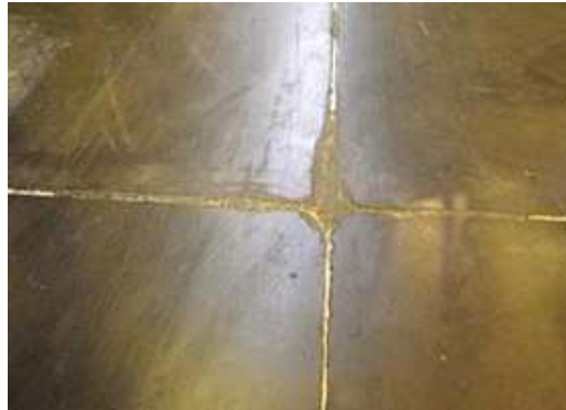
Slika 48. Neravnine na voznoj površini [33]
